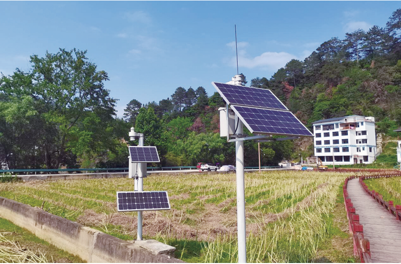
图为贵州台江县台盘乡阳芳村稻鱼基地里，数字化平台中的硬件设备及配套的供电及网络传输设备。
