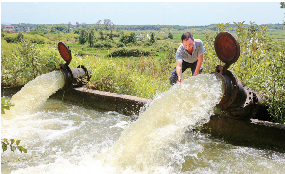
8月23日，在江西省抚州市金溪县琉璃乡澳塘村电力排灌站，当地党员干部察看电力排灌设施运行状况，保障周边稻田灌溉用水。 邓兴东 摄 新华社发
