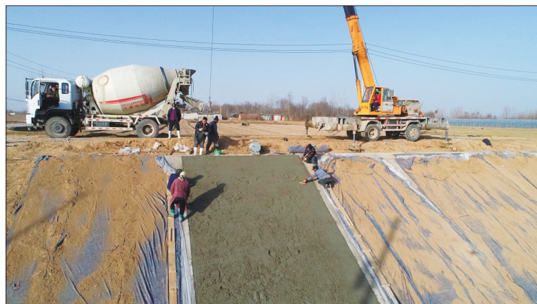
日前，山东阳谷县投资1000多万元对基本农田水利设施进行高标准、高规格维修和建设，确保全县农田灌溉得到保障。全县已维修和建设桥、涵、闸60余座，加固河坡70余公里。图为施工人员在该县寿张镇刘堂村河段用水泥加固河坡。 陈清林 李贵波 摄
