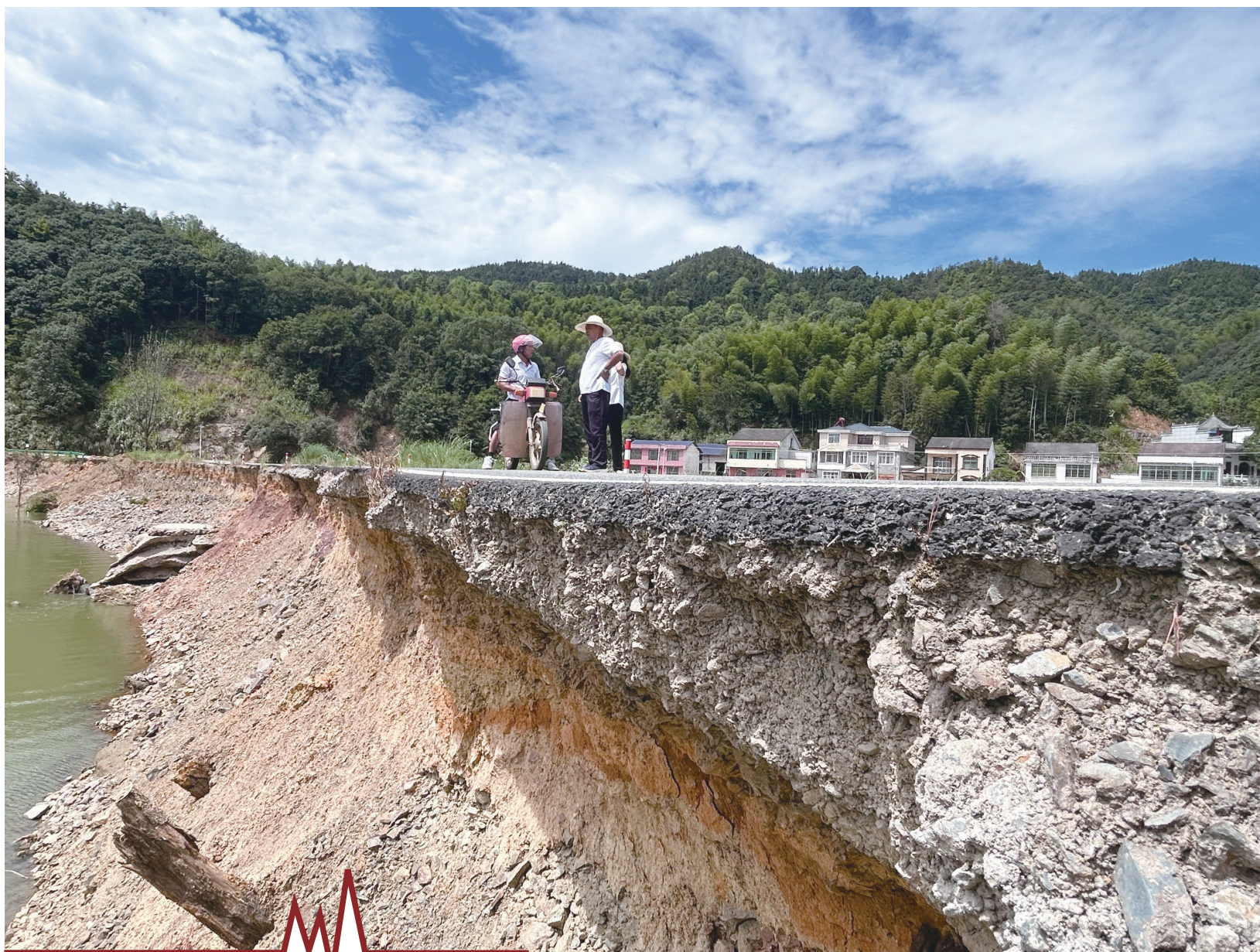
三新村,洪水冲毁了路基,道路变得“空心”。
