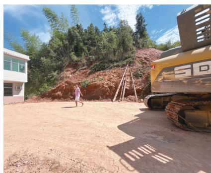
大洞口村一挖掘机正帮农民处理山体滑坡。
