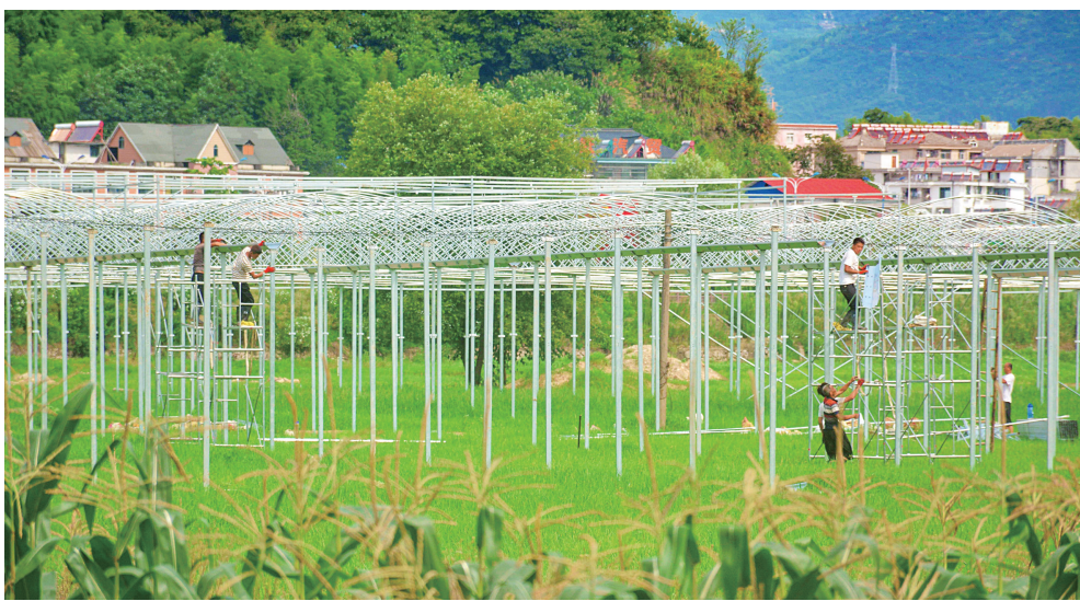
近年来,安徽省安庆市岳西县强化农业基础设施建设,补齐硬件短板,提高生产效率,带动农民增收。图为7月17日,岳西县现代农业蔬菜产业园项目现场,工人正在加紧建设大棚。吴均奇 摄
