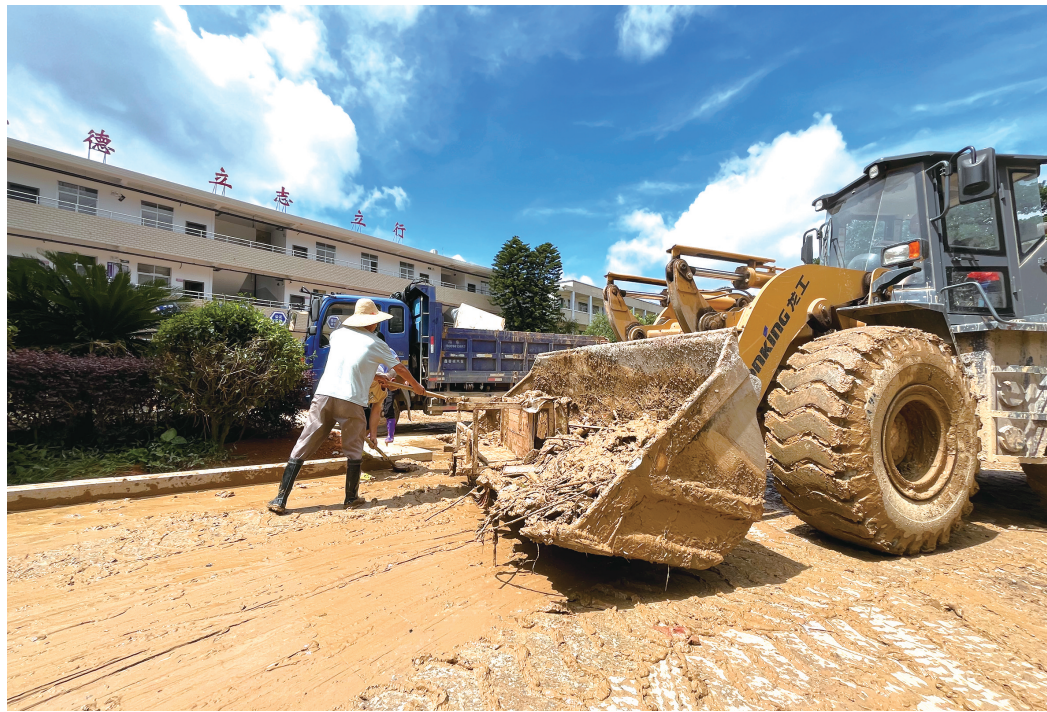
6月21日,在福建省龙岩市上杭县蓝溪镇集镇,大型机械开展道路清淤工作。近日,福建龙岩遭受洪涝灾害。面对复杂严峻的灾情,龙岩各地第一时间转移受灾群众,加紧排涝,加快对基础设施的抢险抢修,全力开展抗洪救灾。
