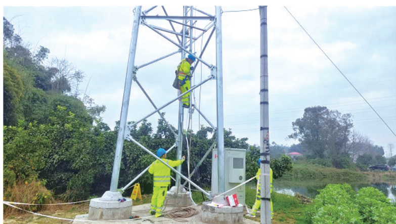
近年来,重庆市梁平区加快推进5G通信基站建设,目前已累计建成5G通信基站2000多个,全区300多个行政村基本实现5G信号全覆盖,让广大群众享受便捷的上网体验。图为梁平区龙门镇河源村7组,中国铁塔股份有限公司重庆市分公司工作人员正在安装信号塔。孙莎莎摄
