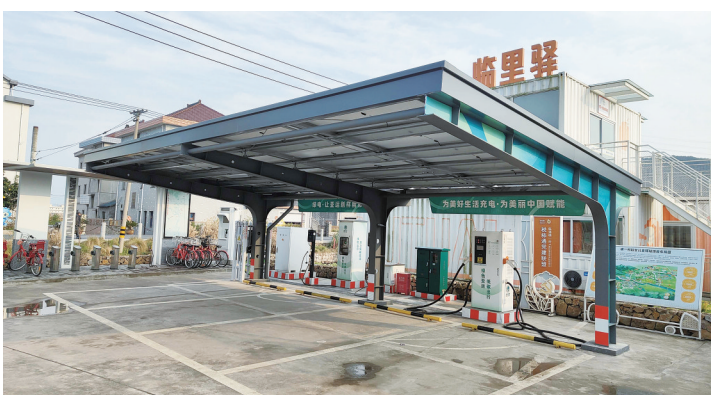
浙江省杭州市萧山区临浦镇横一村临里驿充电桩站点的新能源车棚光伏+分布式储能+新能源充电桩。
